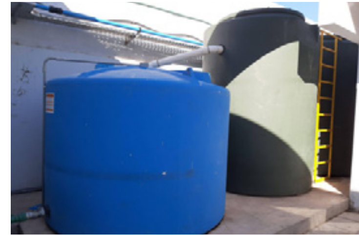
*Planta de adecuación de aguas grises
